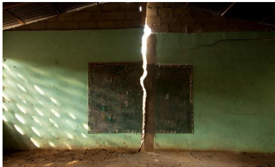
Figura 63. Silencio con grieta , Las Palmas (Bolívar, Colombia), 2011
