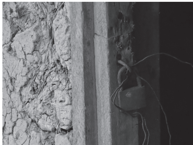
Figura 4. Casa ruinosa. Vereda Pasquilla, localidad de Ciudad Bolívar
